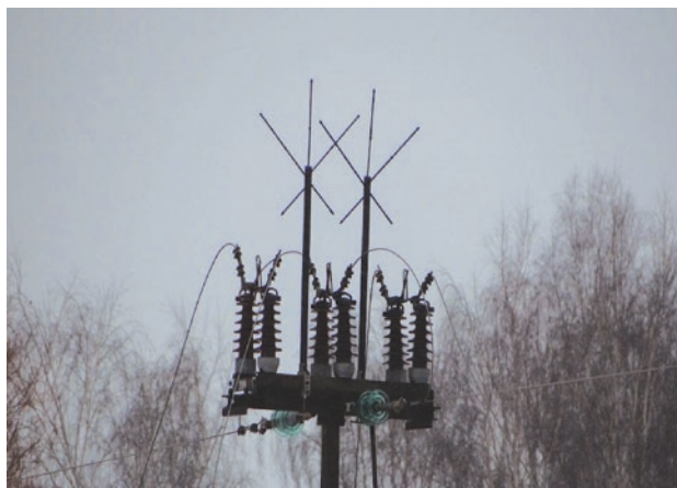
Rys. 4. Separator skonstruowany przez specjalistów z branży elektroenergetycznej we współpracy z ornitologami swym kształtem nawiązuje do kryza św. Andrzeja. Okazało się, że to bardzo skuteczne rozwiązanie całkowicie eliminujące śmiertelne porażania prądem bocianów (fot. S. Linowski) Fig. 4.
